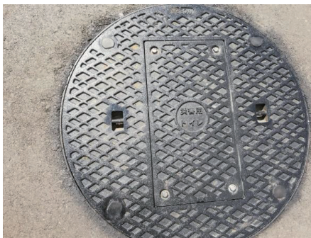
【松の実園のマンホールトイレ】 災害時はこのマンホールの上に トイレを設置します
